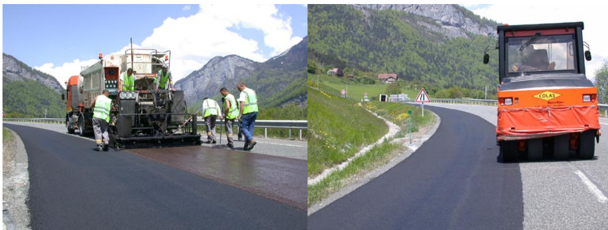
photo 3 : vue d'ensemble d'une machine à ECF (Jean-Pierre Henrat - COLAS).
